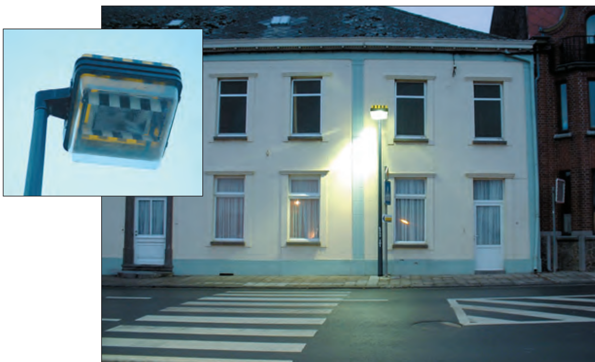
Figures 1 et 2: exemples d'éclairage recommandé pour la sécurité des piétons. © GAMAH
