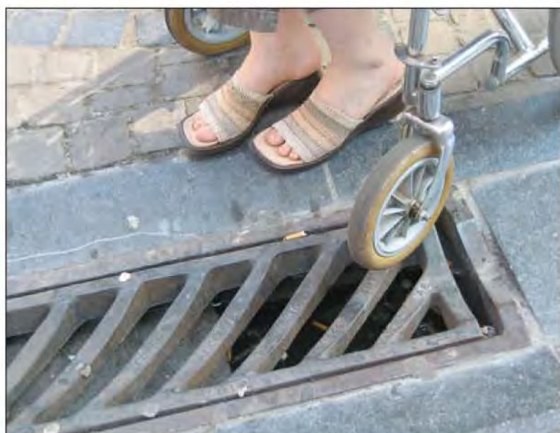
Figure 5 : les avaloirs constituent un réel danger pour les personnes à mobilité réduite. © Access+
