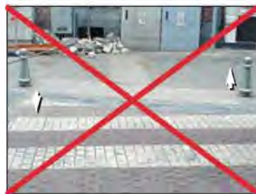
Figure 7: les dalles à protubérances doivent toujours être perpendiculaires à l'axe de la traversée. © GAMAH
